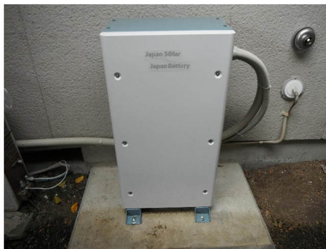
写真1 我が家の家庭用リチウム蓄電池
